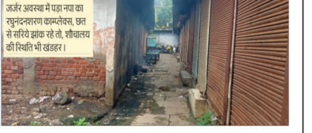
जर्जर अवस्था में पड़ा नाया का रघुनंदनशरण काम्प्लेक्स, छत से सरिये झाक रहे तो, शौचालय की स्थिति भी खंडहर।
